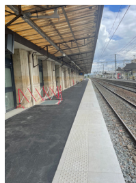
Aménagement de quai pour la mise en accessibilité de la gare du Mans - Crédit photo : Gaëlle Le Breton, DREAL
